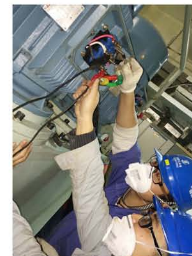
调速器油压装置油泵电机直阻测量
