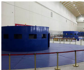
锦屏二级水电站第二批机组投产发电
