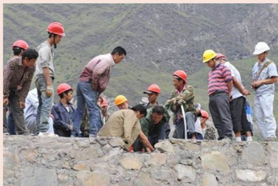
浆砌石挡墙破坏性检查
