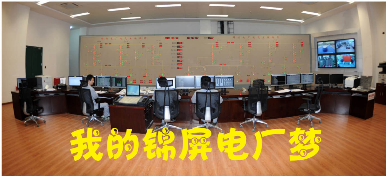
公司锦屏水力发电厂 苗睿智
